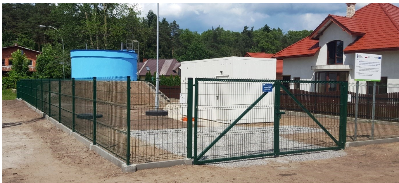
OSIEDLE PORĘBY DĘBSKIE — hydrofornia przy ul. Strażackiej
