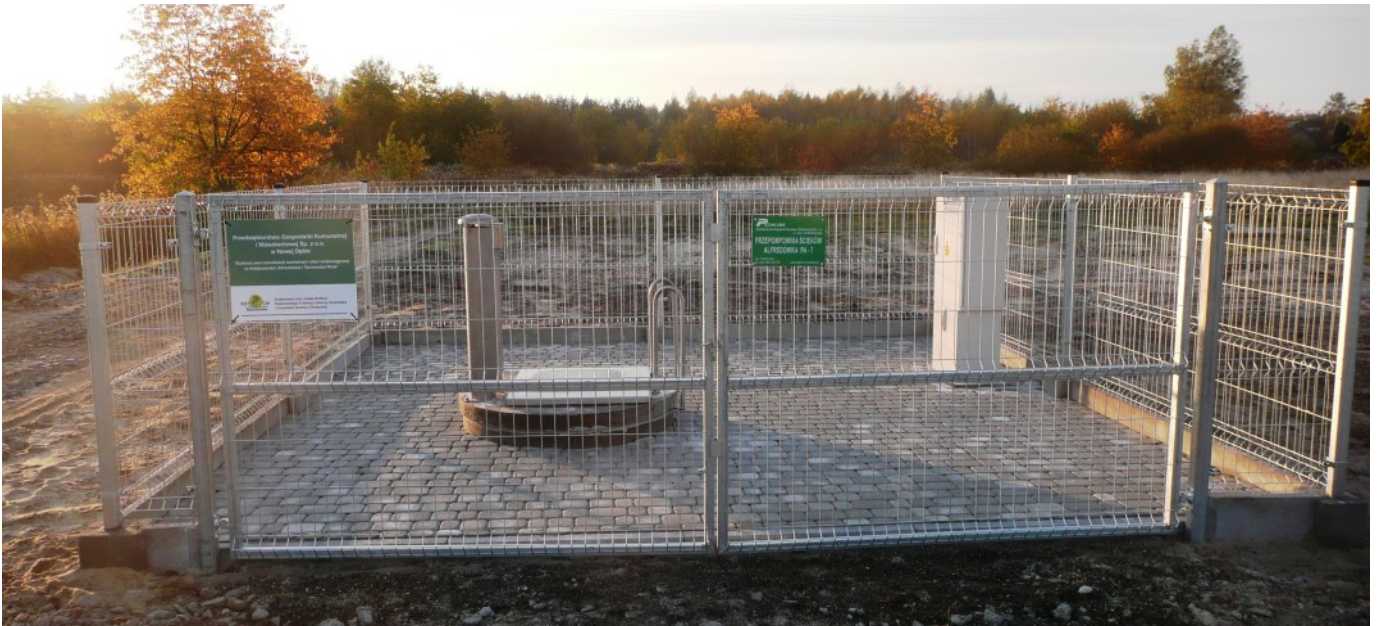
ALFREDÓWKA — przepompownia kanalizacji
