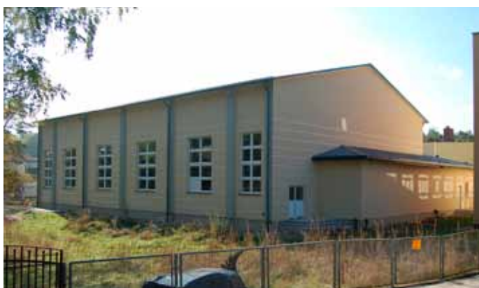
Hala sportowa przy Szkole Podstawowej nr 2 - gotowa jest już elewacja oraz drzwi i okna
